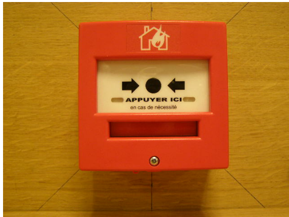
4710R1 en état d'attente 4710R1 in normal condition
