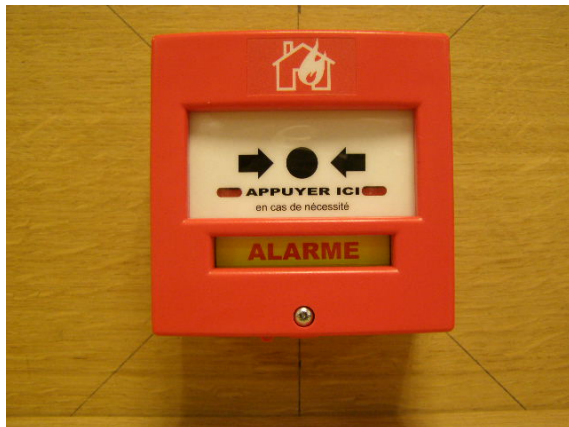
4710R1 en état d'alarme 4710R1 in alarme condition
